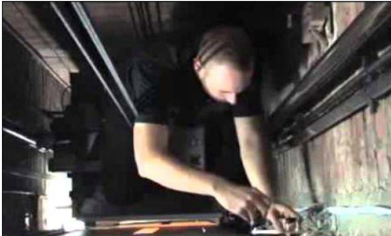
Handwerker können im Weiterbildungszentrum von Krakelshaff in einem Fahstuhlschacht üben. (Bild: AFP)
